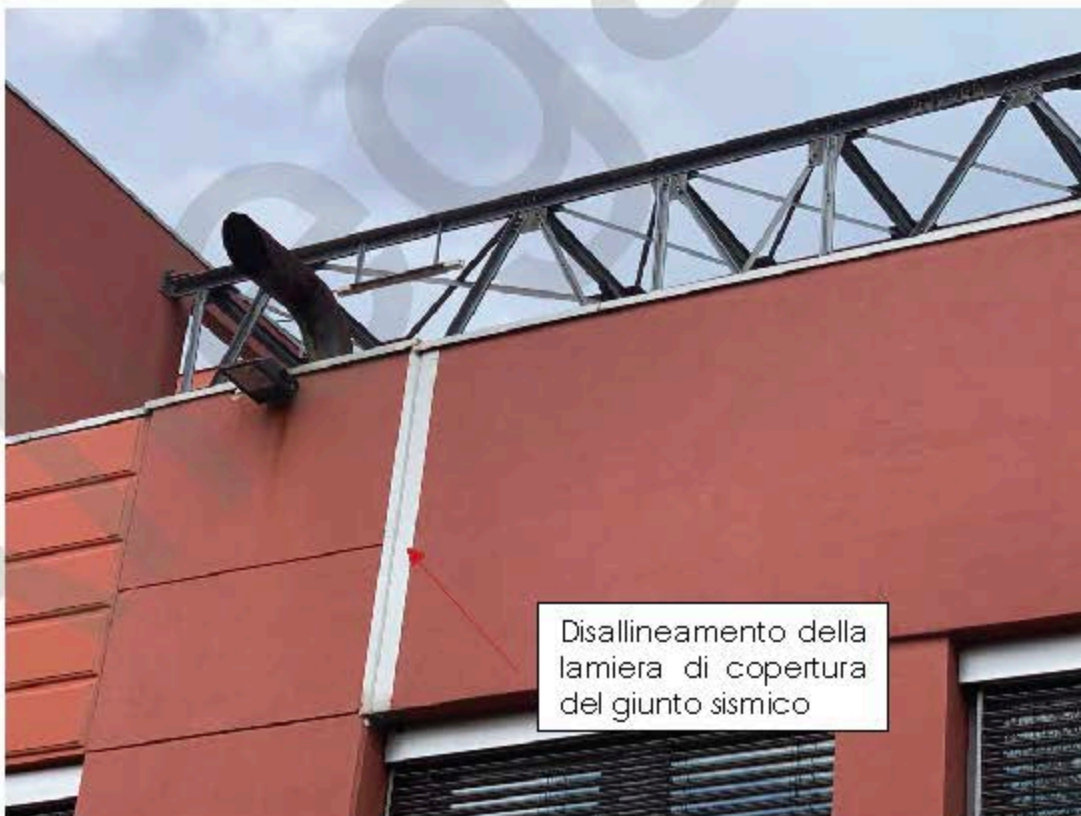
Figura 13 - Quadro fessurativo - Disallineamento della struttura in corrispondenza del giunto sismico
